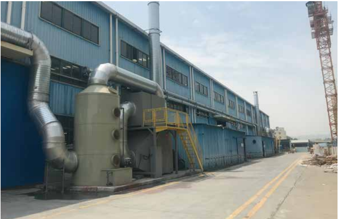
Waste gas treatment project 廢氣處理工程
